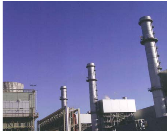
HRSG Stacks Units 1, 2 and 3
