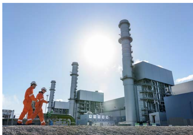
HRSG Stacks Units 1, 2 and 3
