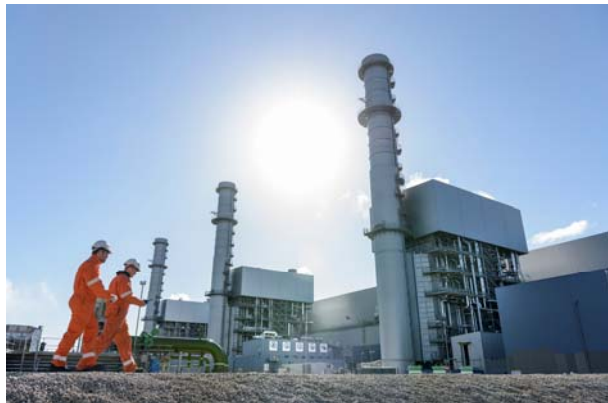
HRSG Stacks Units 1, 2 and 3
